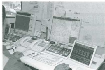
更新した消防緊急通信指令装置
