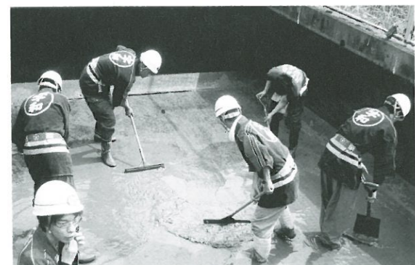
防火水槽の清掃
