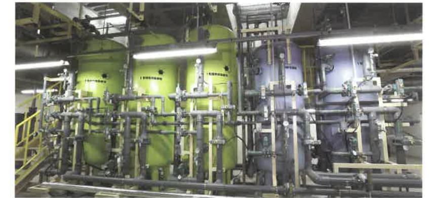
■砂ろ過塔・活性炭吸着塔
