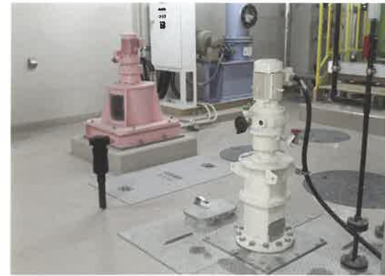
■凝集沈殿設備
