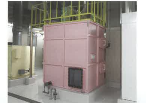
■中濃度臭気活性炭吸着塔
