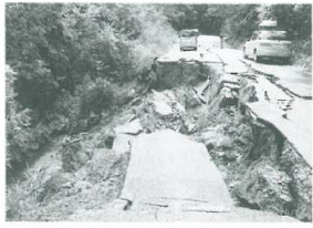
▲寸断された国道398号線（宮城県栗原市花山地区） ※近代消防8月号から転用
