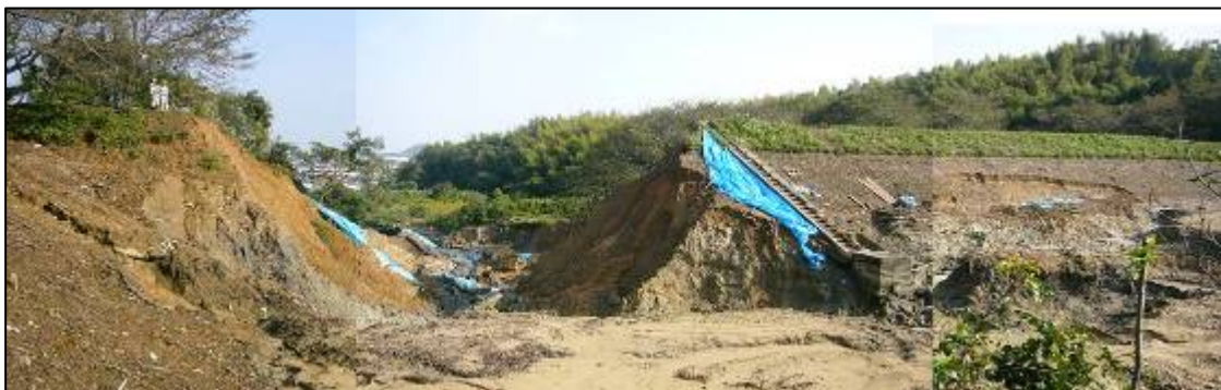
【台風15号(H16.8.18)による堤体の被災状況】
