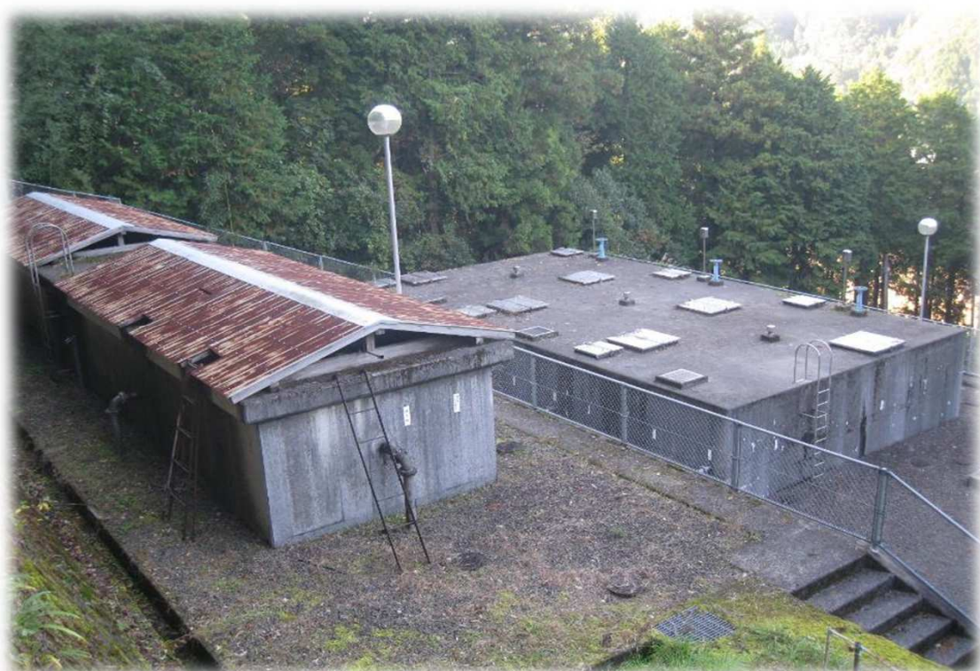
西予市城川地区 下相上簡易水道
