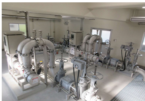
津布理浄水場
