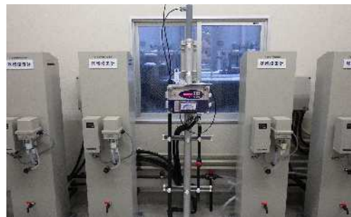
浄水濁度計（測定状況）
