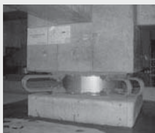
免震装置(宇和島市立病院)
