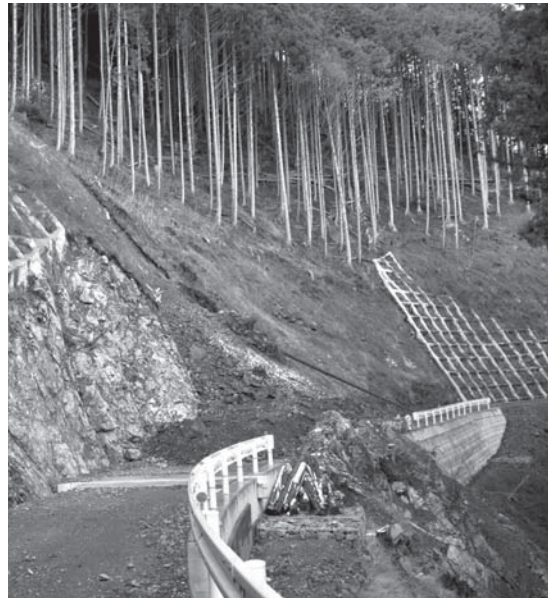
林道崩壊状況(中筋)
