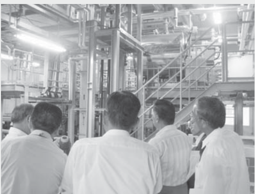
仙北市汚泥処理センター
