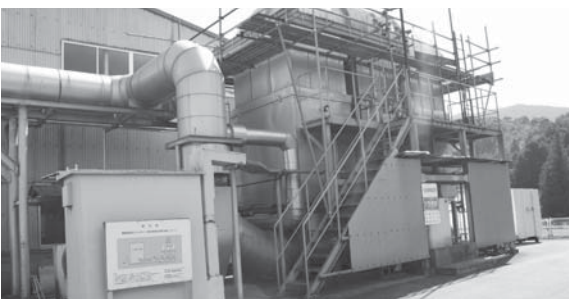
野村クリーンセンター(ダイオキシン処理施設)
