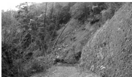
土砂崩落箇所（内場樽線）
