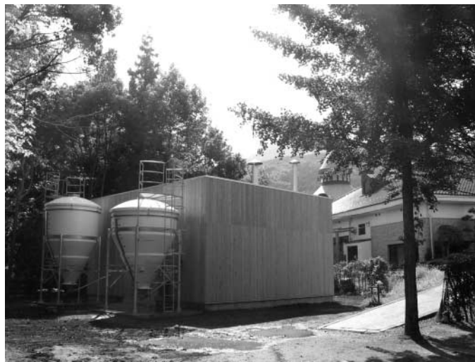
再生可能エネルギーへの第一歩 「游の里」ペレットボイラー
