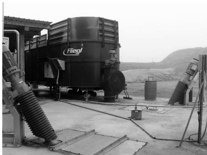
ドイツ・バイオガス第一次発酵槽
