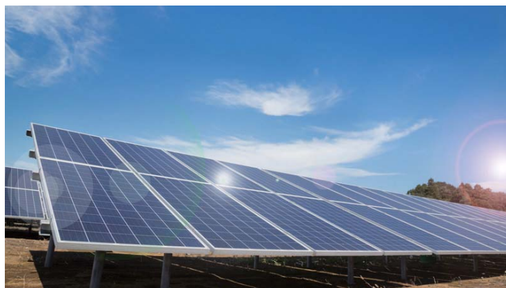
太陽光パネル
