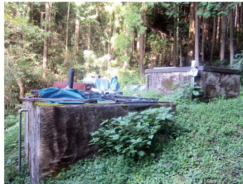
老朽化した共同給水施設(城川町)
