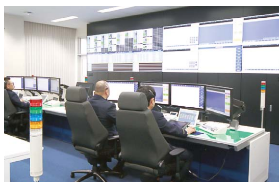
共同運用されている消防指令センター(栃木県大田原市)
