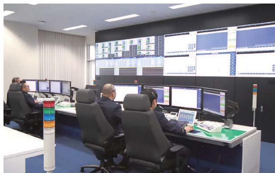
消防指令センター（栃木県那須地区消防本部）
