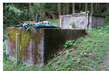
山水をろ過・貯水しているタンク（城川町）
