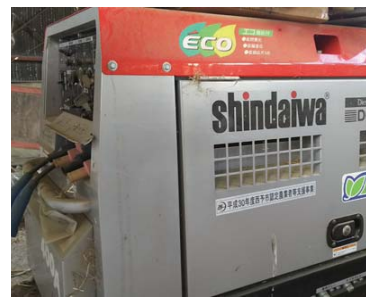
災害時に活躍する発電機
