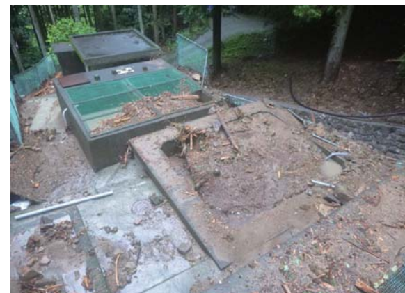
簡易水道の被災現場(城川町高野子)
