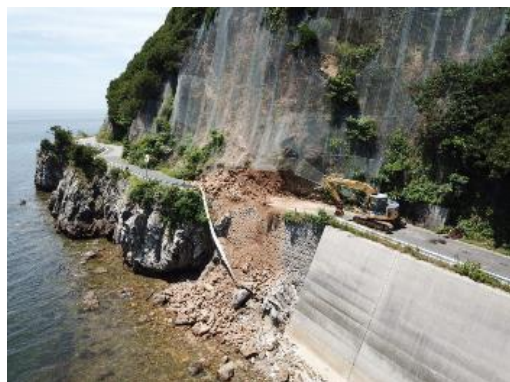
国道 378 号被害（宮野浦）
