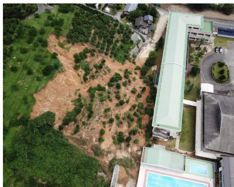
急傾斜地の崩壊（下ノ谷地区）
