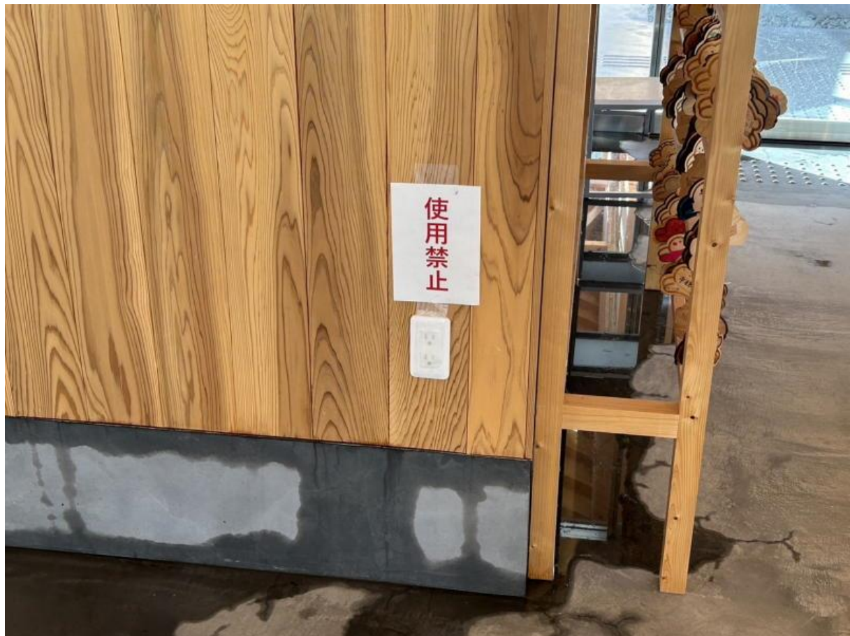
漏水の状況写真
