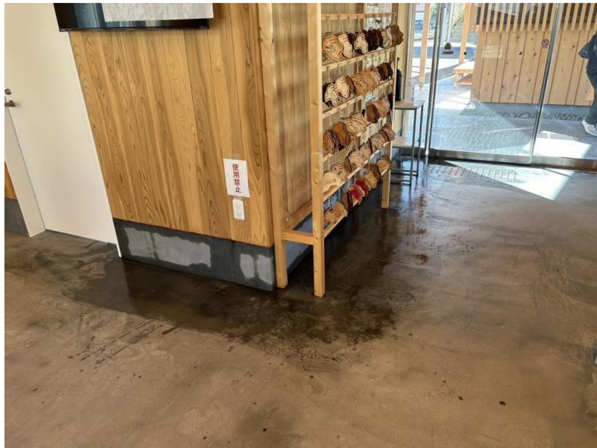
漏水の状況写真
