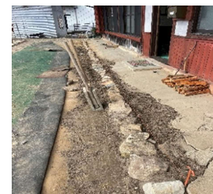
崩れた犬走りのコンクリート
