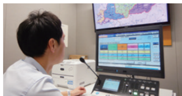
整備工事が終わった防災行政無線の放送設備
