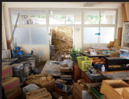
明浜中学校では、校舎の裏山から土砂が流れ込んだ。
