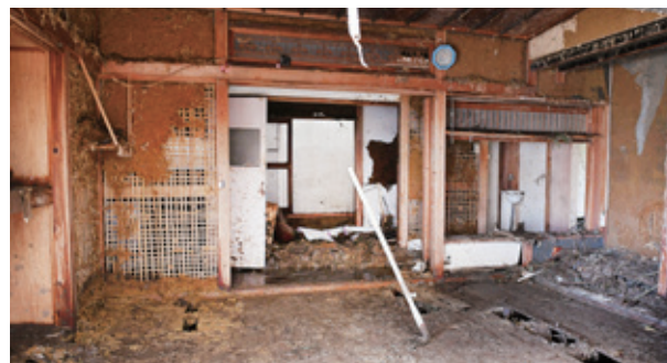
家具の運び出しを終えた、被災住宅の内部。浸水により壁ははがれ、天井には泥の跡が残る。
