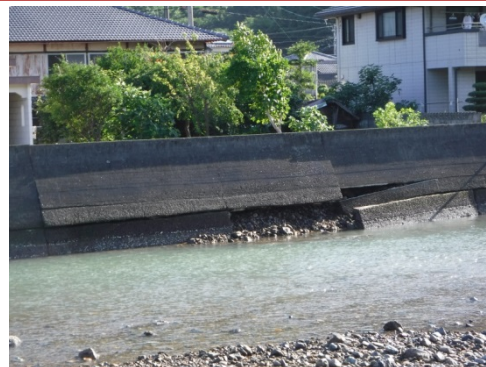
三島川護岸被害（蔵貫浦）
