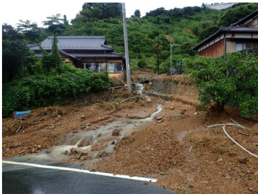
土砂の流出（俵津：脇川）
