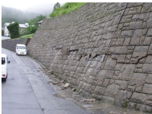
宇和米博物館擁壁のき裂
