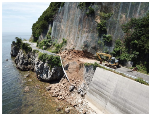
国道 378 号被害 (宮野浦)
