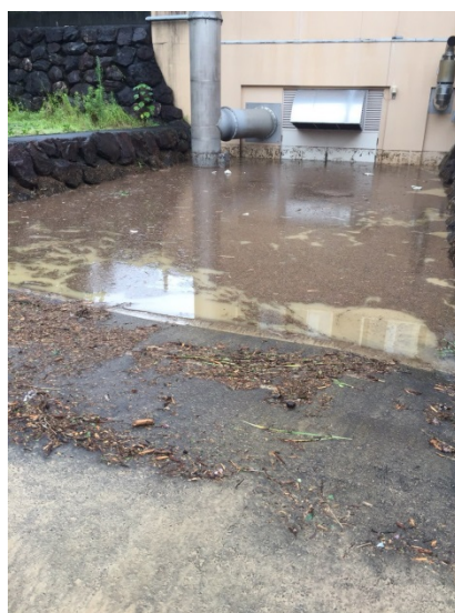
クアテルメ宝泉坊 ボイラー室の浸水
