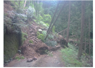
市道被害（窪野地区）
