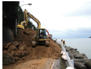
国道 378 号被害 (有網代)
