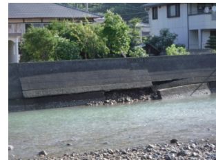
三島川護岸被害（蔵貫浦）
