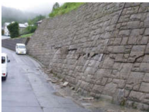
宇和米博物館擁壁のき裂
