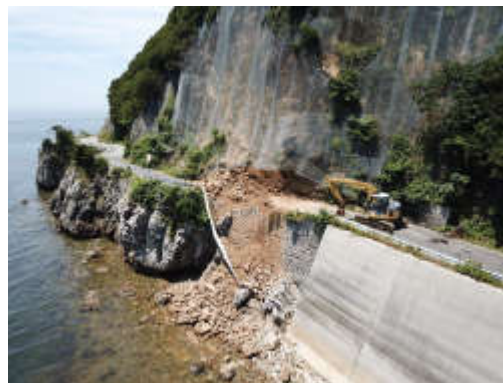
国道 378 号被害 (宮野浦)
