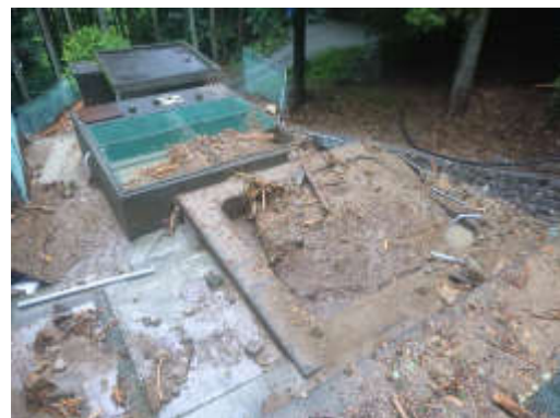
簡易水道被害（高野子）
