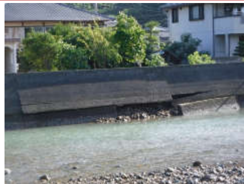
三島川護岸被害（蔵貫浦）
