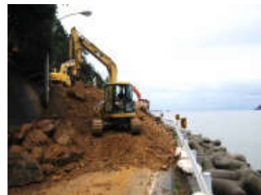
国道 378 号被害（有網代）
